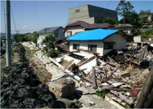
ブロック塀が倒れ、1階などが倒壊している（益城町）
