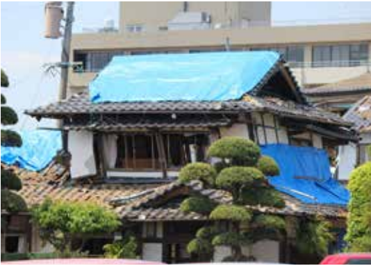
震災後、現地ではブルーシートが足りないといった声も上がっていた（益城町）
