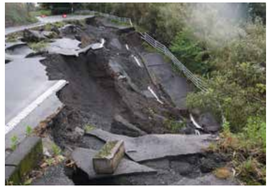
大きく道路が陥没している（南阿蘇村）
