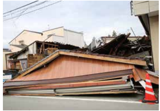
1層部分が完全に押しつぶされている家が多かった（益城町）
