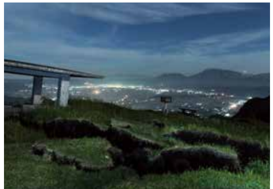
阿蘇カプト岩展望所の地割れ。街の明かりが自然の猛威を照らし出す
